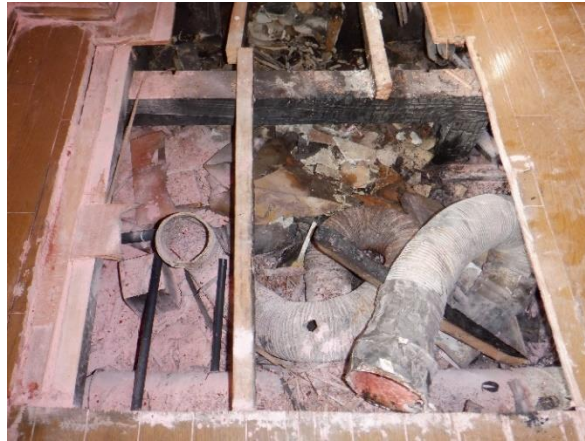
下引きダクト方式：排気ダクトが床下を通っている
