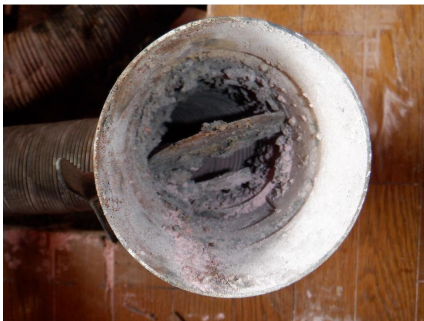
清掃不足により、油脂が固着して閉鎖しない防火ダンパー
