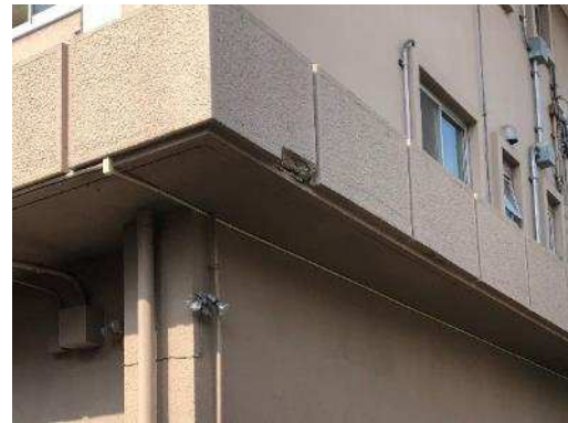
図表 2-7 消防署外壁の一部が欠損
