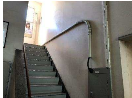
図表 2-9 階段に露出した電気配線
