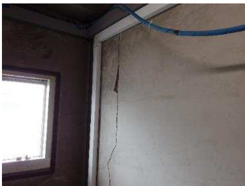
図表 2-8 消防署内壁に発生したクラックの発生
