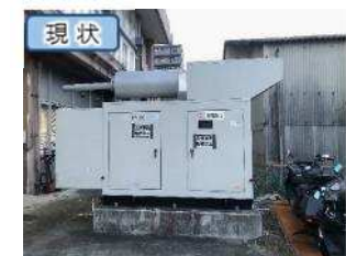
図表 3-57 地上面に設置している現在の非常用電源設備
