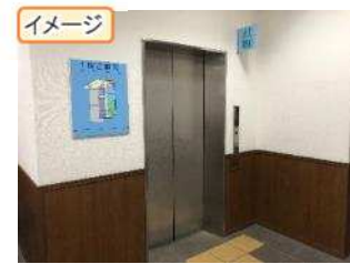
図表 3-65 エレベーター
