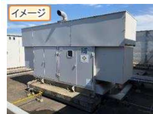
図表 3-56 非常用電源設備
