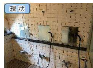
図表 3-47 仕切り板が設置できない浴室
